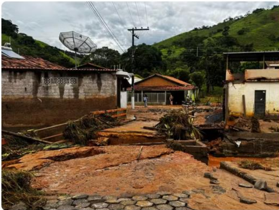
A força da correnteza do córrego do Mingau fez uma ponte cair e outras duas foram interditadas pela Defesa Civil de Dom Silvério — Foto: Fabiano Lobot
