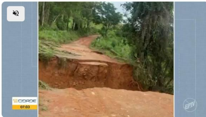
Chuva provoca alagamentos e deixa estragos em três cidades do Sul de Minas
