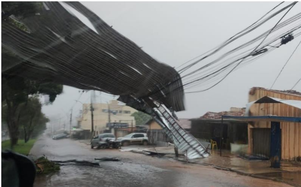
Telhados foram arrancados com a força do vento.
