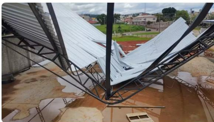
Estrutura metálica cai e dois homens ficam feridos em Três Corações, MG — Foto: Reprodução / Redes sociais
