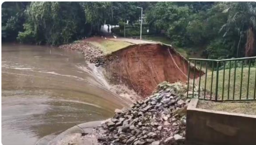
Barragem de água se rompe em parque de Belo Horizonte — Foto: Redes sociais
