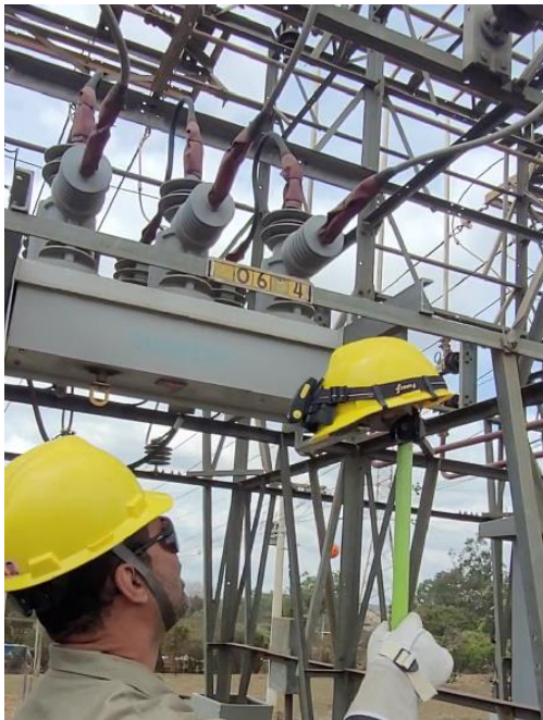
Figura 11 - Teste com o detector Aladin na subestação Sete Lagoas-2.
