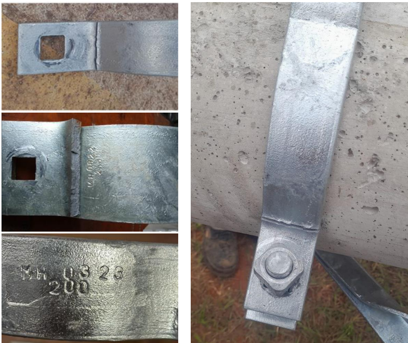
Figura: Registros de suportes e cintas rompidos
