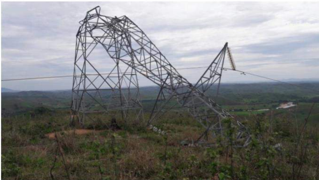
Torres de linha de distribuição caem no Leste de Minas (Fonte: CEMIG/Divulgação)
